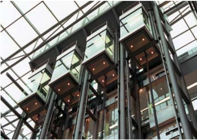
Aufzüge gehören zu den überwachungsbedürftigen Anlagen
