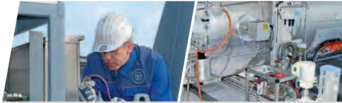
Der VdTÜV und die ZÜS setzen sich für den Drittschutz bei überwachungsbedürftigen Anlagen ein.
