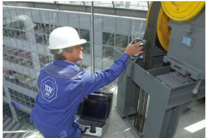
Dank Erfahrungsaustausch immer auf dem neuesten Stand: Der Experte prüft eine Aufzugsanlage.
